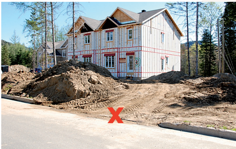
Figure 4 – Accès au chantier sans stabilisation
