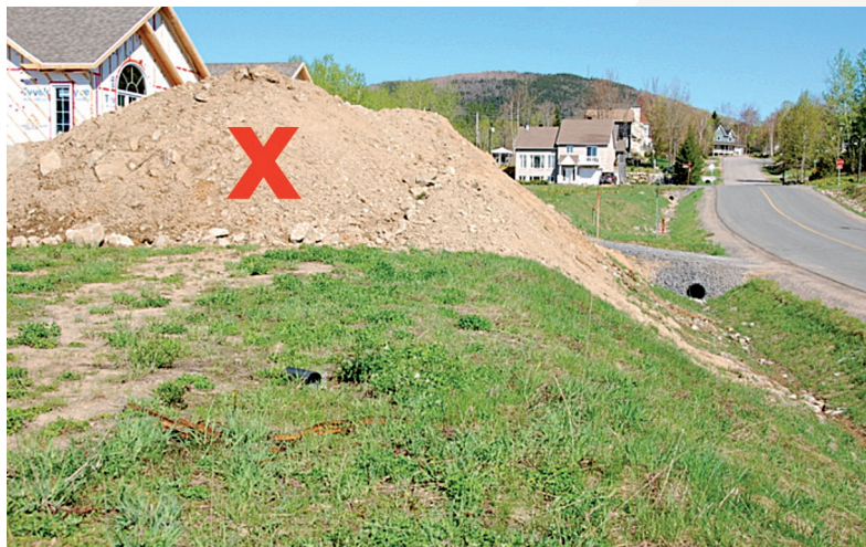
Figure 3 – Entreposage fautif de tas de déblais
