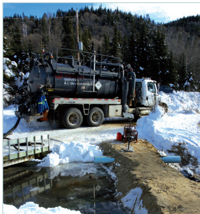
Déversement d'hydrocarbure à Stoneham
